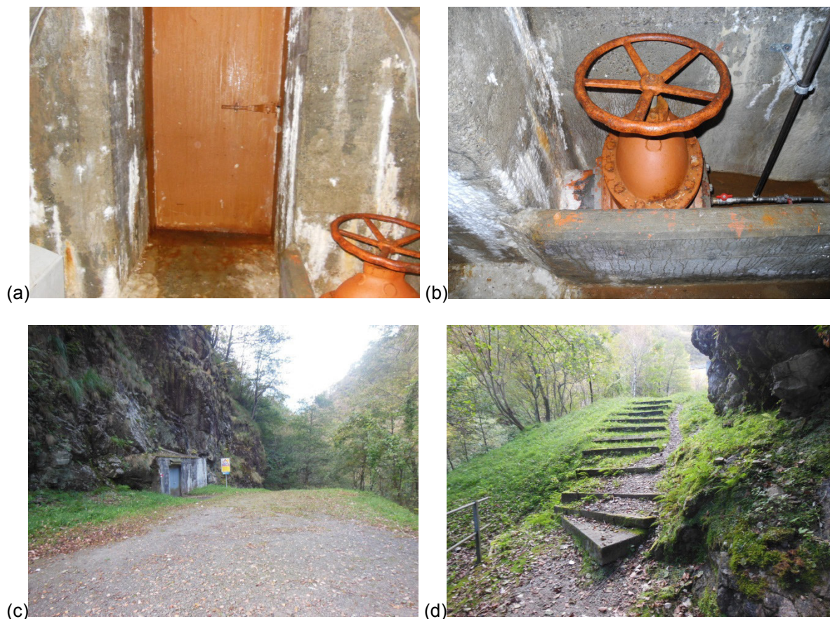
Fig. 6: Ubicazione centralina turbinaggio deflusso minimo a piede diga. (a) porta blindata della galleria di adduzione; (b) valvola esistente; (c) piazzale di accesso alla camera di controllo paratoie; (d) zona in cui verrà posata la condotta di restituzione.
