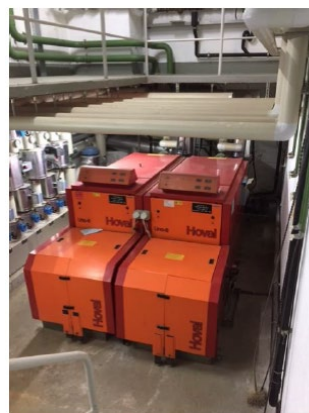
Attuale centrale termica
