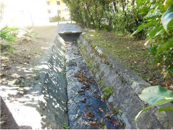
Ba_3.4 (da monte verso valle) - BALMETTA_03, poco a monte dell'inizio del tratto intubato BALMETTA_02
