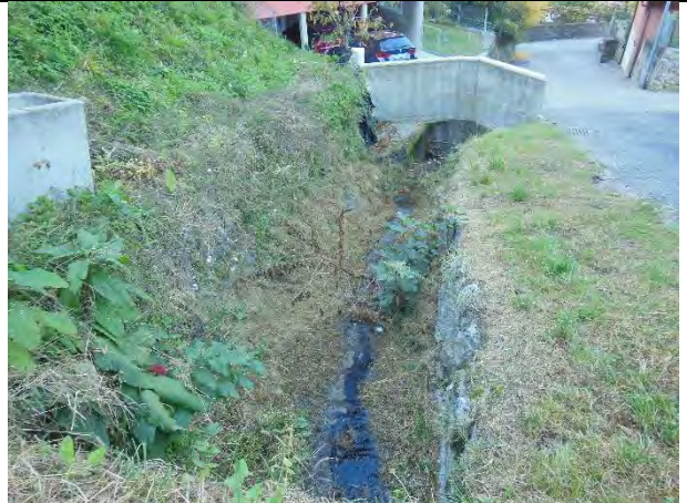
Rg_4.4 (da monte verso valle) -- RIGANELLA_06, a monte dell'imbocco del tratto intubato RIGANELLA_05
