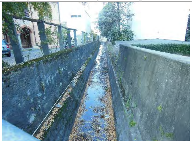
Gu_2.10 (da monte verso valle) -- GUASTA_02
