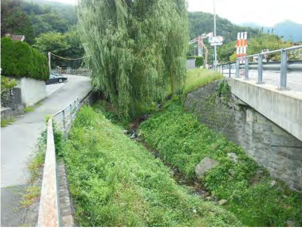
Dr_3.7 (da valle verso monte) -- DRAGONATO_03, a monte dell'attraversamento di via Ospedale
