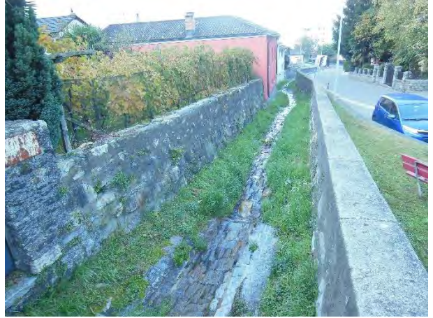
Gu_2.3 (da monte verso valle) -- GUASTA_02
