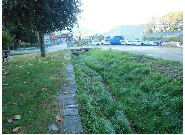
Gu_2.12 (da monte verso valle) -- GUASTA_02
