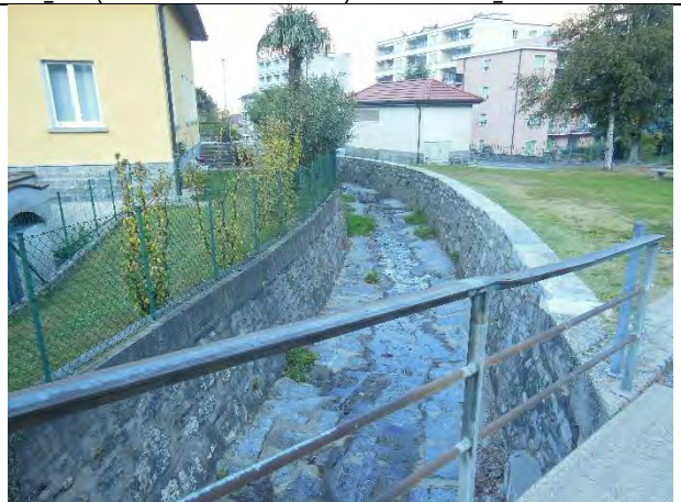
Gu_2.8 (da monte verso valle) -- GUASTA_02
