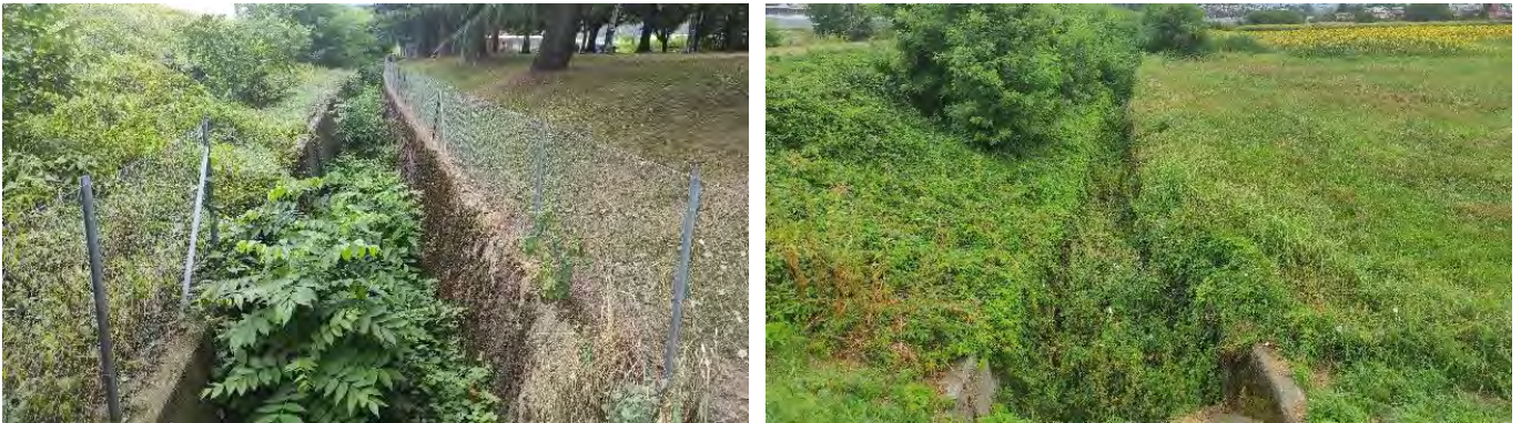
Fig. 8 Stato del canale a monte delle piscine (segmento SALEGGI_04). A sinistra foto scattata in corrispondenza della casa anziani Greina (parcella 450 RFD di Bellinzona). A destra foto scattata all'altezza della piazza di giro su Viale Giuseppe Motta (parcella 598 RFD di Bellinzona).
