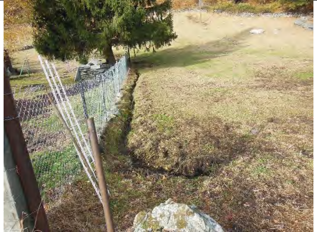
Lu_x2 (da valle verso monte) - Drenaggio (tratto non considerato)
