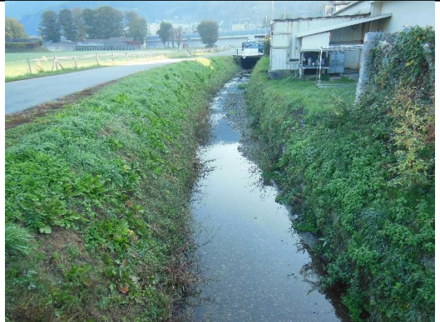
Gu_1.1 (da valle verso monte) -- GUASTA_01, a valle del tratto intubato GUASTA_02
