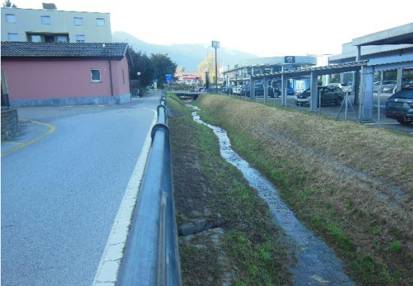
Gu_2.13 (da monte verso valle) -- GUASTA_02
