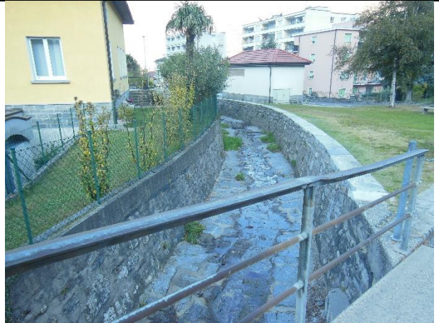
Gu_2.8 (da monte verso valle) -- GUASTA_02
