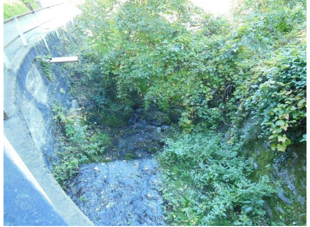
Da_4.2 (da monte verso valle) -- DARESE_04, a valle di via ai Ronchi
