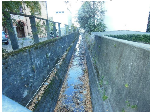
Gu_2.10 (da monte verso valle) -- GUASTA_02
