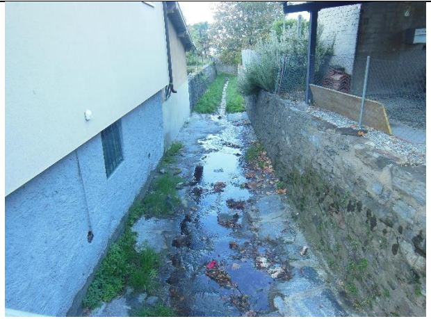
Gu_2.6 (da monte verso valle) -- GUASTA_02
