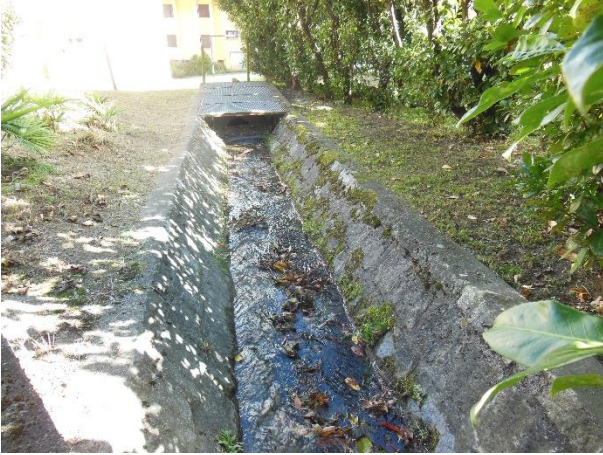
Ba_3.4 (da monte verso valle) - BALMETTA_03, poco a monte dell'inizio del tratto intubato BALMETTA_02
