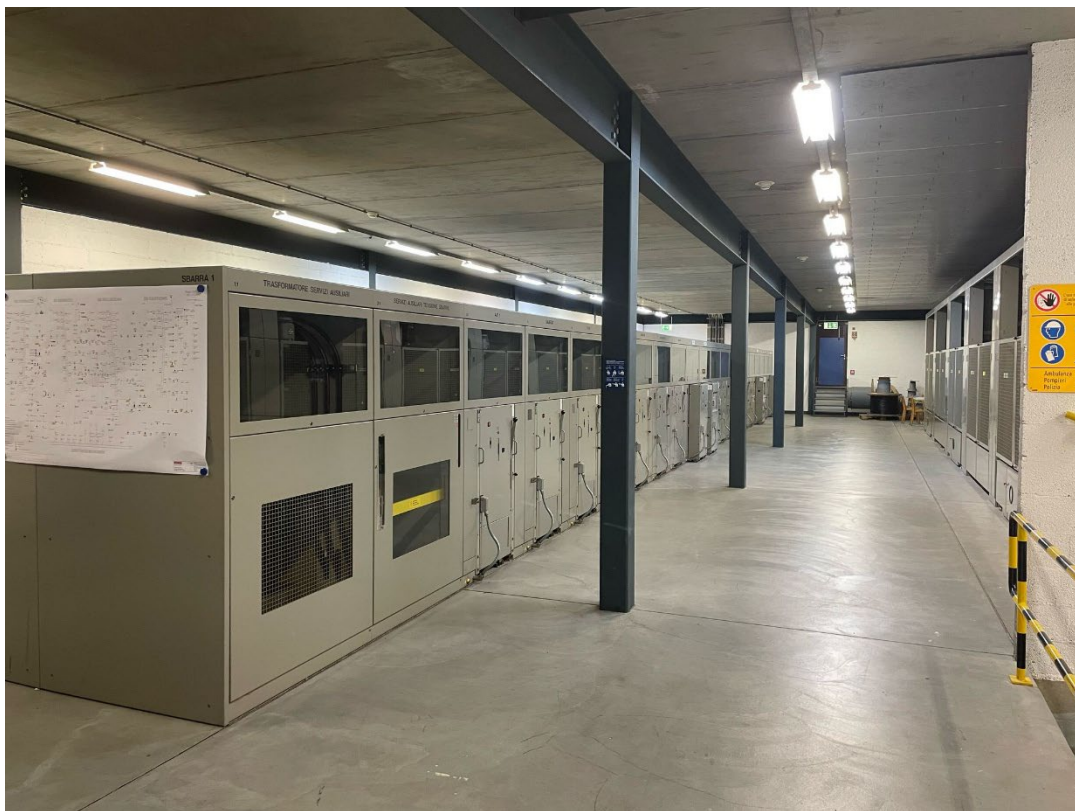
Figura 3: celle di media tensione presso la SS Giubiasco
